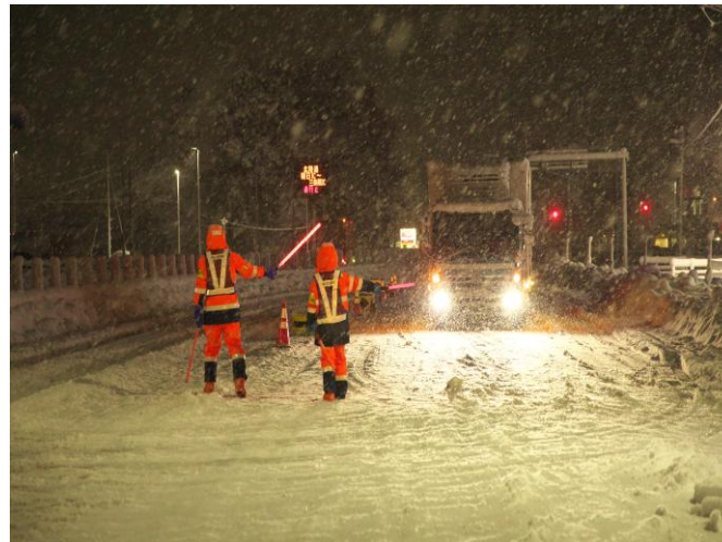
集中除雪による交通規制【国道8号 富山県小矢部市】 (R8.1.25撮影)
