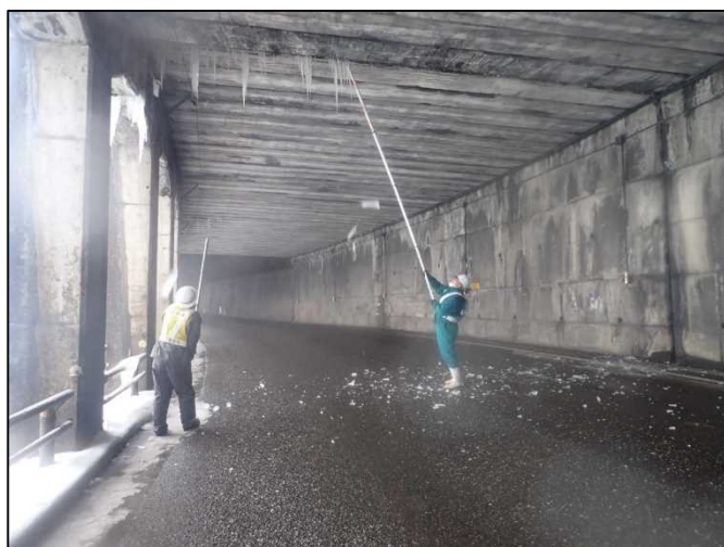
つらら処理【国道8号 新潟県糸魚川市】 (R5.1.25撮影)
