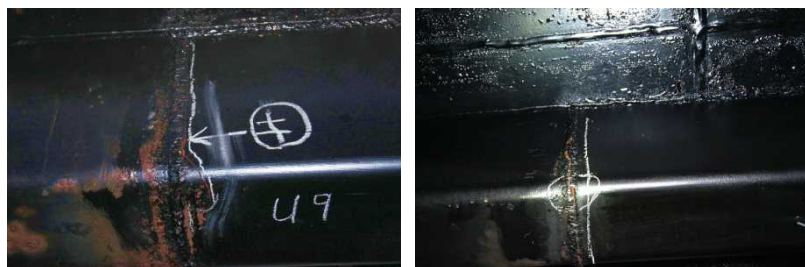
▲Uリブの亀裂状況
