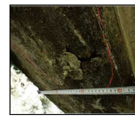
主桁の損傷状況(鉄筋露出)
