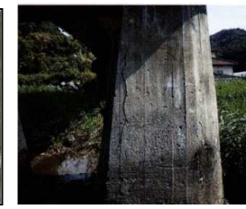
下部工の損傷状況(ひびわれ)
