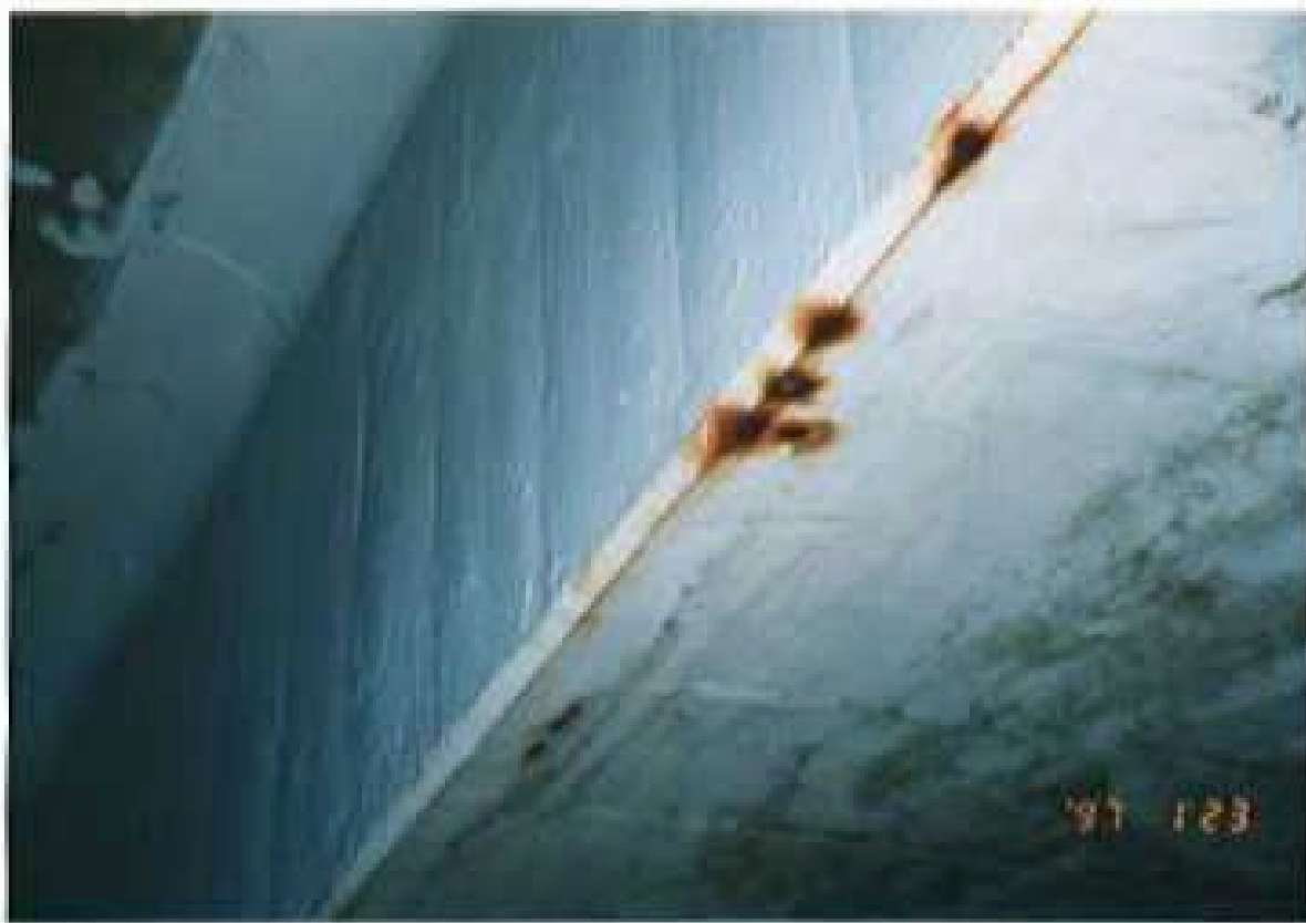
R C 桁下面の点錆
