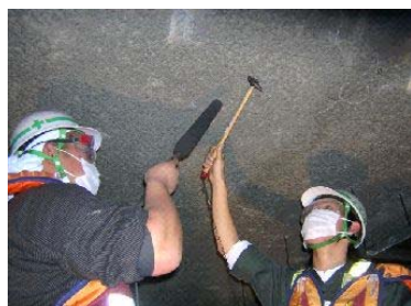
打音法実施状況
