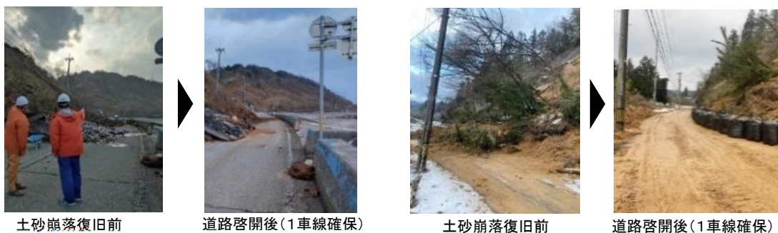
図 4.1.2 能登半島地震における道路啓開(左から 1,2 枚目:国道 249 号 左から 3,4 枚目:(一)高屋出田線)
