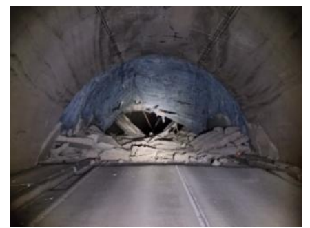
中屋トンネルの被災状況
