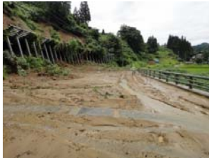
写真1 新潟・福島豪雨被災状況(H23.7)
