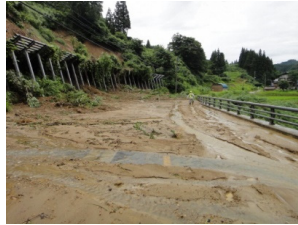
写真1 新潟・福島豪雨 被災状況(H23.7)
