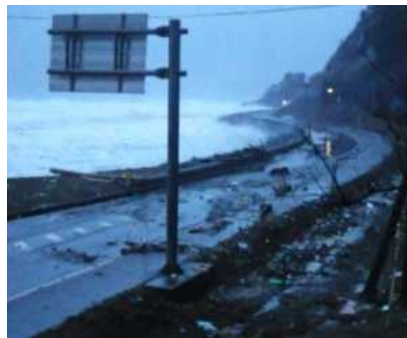
図3 国道7号 越波による通行規制(H24.4)
