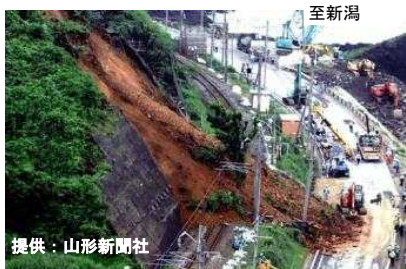
図1 法面崩壊(鶴岡市小岩川地区)
