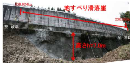
写真2 岩福地区の国道下斜面崩落 (H22.3.9)
