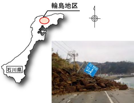
写真1 国道249号の被災状況（能登半島地震時）
