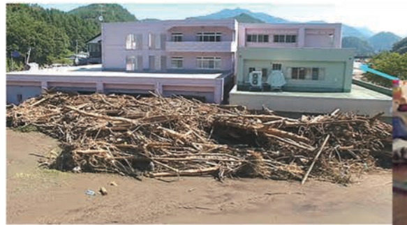
岩手県で被災した要配慮者利用施設
