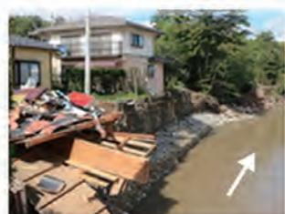
洪水時の侵食による被災 (佐久市原地先)
