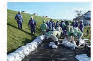
水防活動状況 令和元年東日本台風 出水漏水箇所 信濃川・長岡市橋下地先
