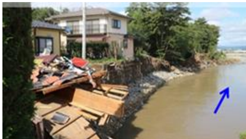
▲ 洪水時の侵食による被災（佐久市原地先）
