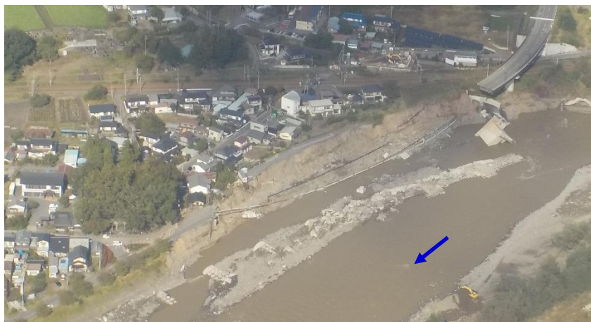
▲ 洪水時の侵食による被災（東御市海野地先）
