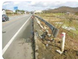
ガードレール・ 標識等の損傷
