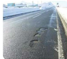
路面の穴ぼこ・ 段差
