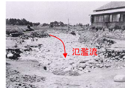
氾濫流による洗掘状況(黒部市荻生地先)
