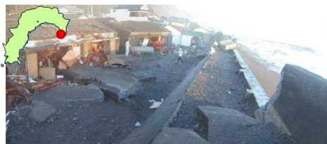
高波による菜生(なばえ)海岸の被災状況 (H16.10 高知県室戸市)
