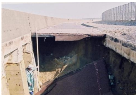
天端陥没 (平成14年1月 片山津工区)
