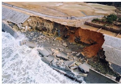
堤防決壊 (平成12年1月 小松工区)
