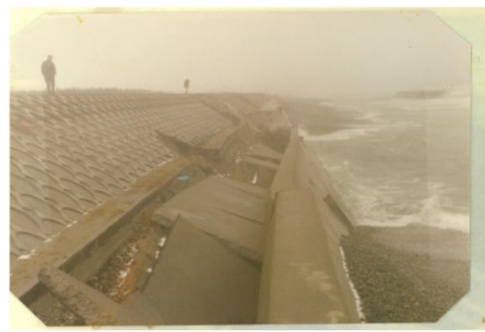
堤防倒壊 (昭和55年1月 根上工区)
