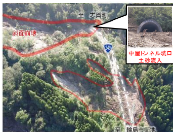
(大雨被災状況 R6. 9)
