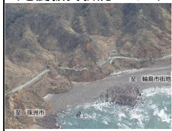
③大川浜工区 (地震被災状況 R6. 1)
