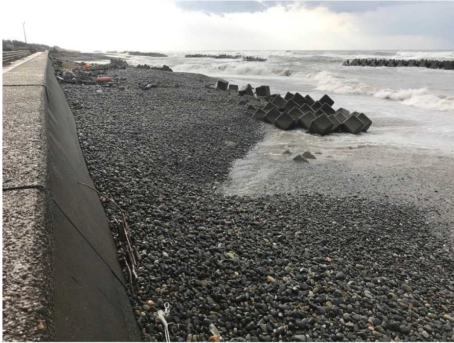
R3.11.25 巡視確認 (排水暗渠閉塞)
