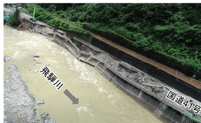
国道41号 道路崩壊 (岐阜県下呂市)
