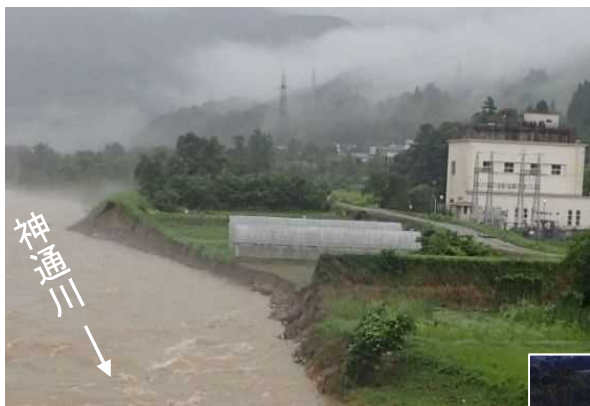
被災状況（平成30年7月7日）
