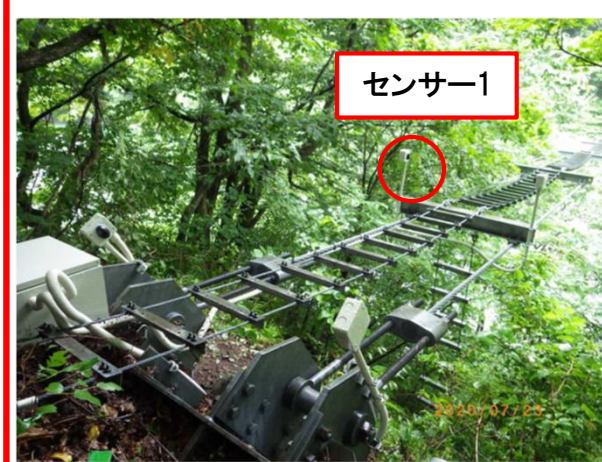
人感センサー設置状況
