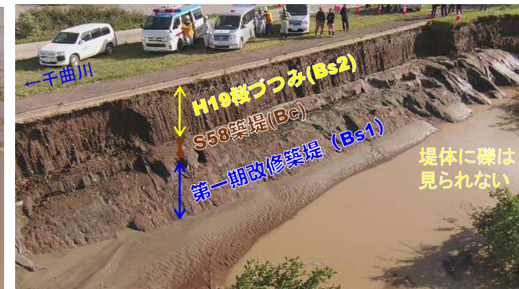
決壊部上流側川裏の状況
