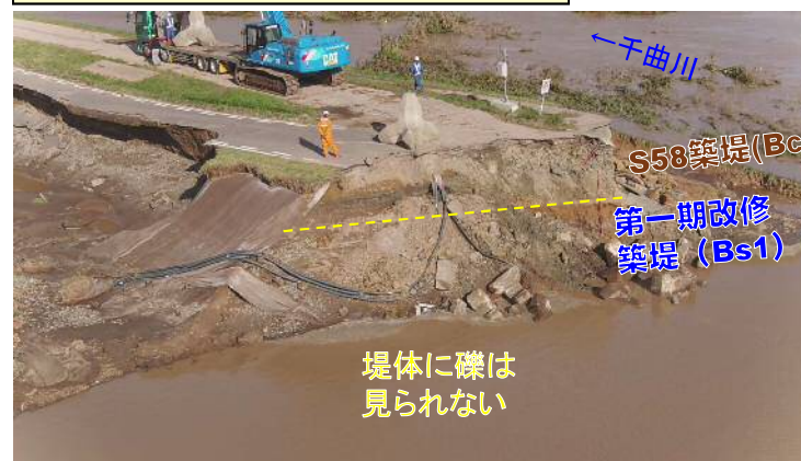
決壊部下流側川裏の状況
