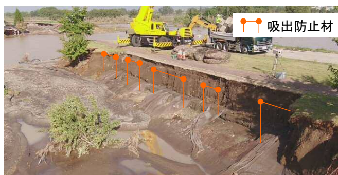
④堤体に残存する吸出防止材
