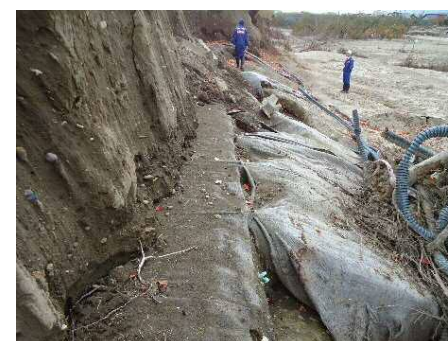
⑤堤体に残存する吸出防止材
