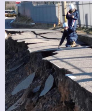
令和6年能登半島地震 道路の被災状況調査(石川県輪島市河井町)
