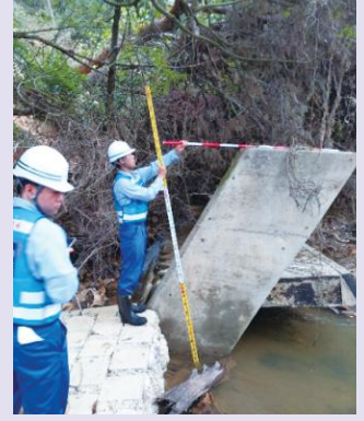
令和6年9月の豪雨災害 河川の被災状況調査（石川県珠洲市）
