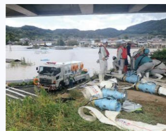
↑排水ポンプ車
