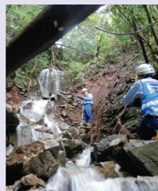
令和2年7月豪雨 砂防の被災状況調査(熊本県山江村)
