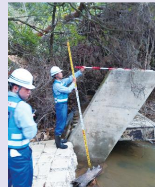
令和6年9月の豪雨災害 河川の被災状況調査(石川県珠洲市)
