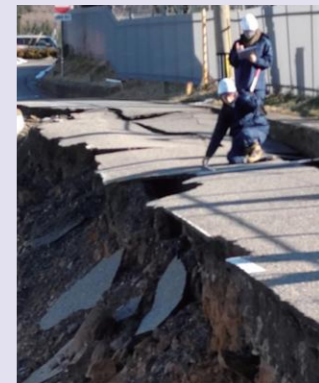
令和6年能登半島地震 道路の被災状況調査(石川県輪島市河井町)
