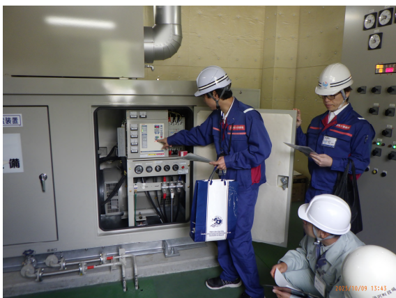
【非常電源用発電機の起動操作訓練】 非常電源用発電機の起動方法、 注意点の確認
