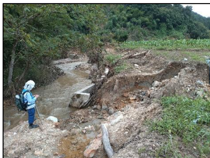
河川における被災状況調査 [氷見市上余川地先]
