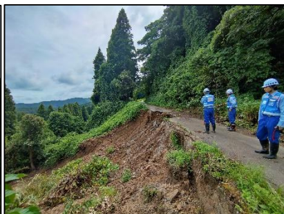
道路における被災状況調査 [氷見市棚懸(たながけ)地先]
