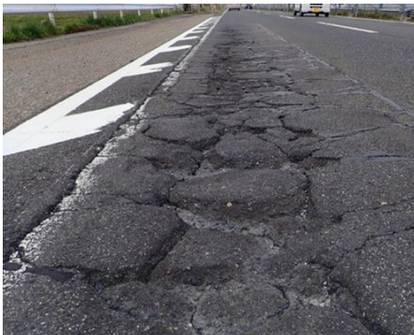
舗装のひび割れ
