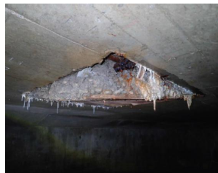
橋の裏面の損傷
