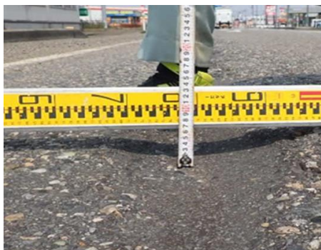
舗装のわだち掘れ
