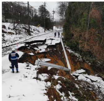
道路被害状況の調査
