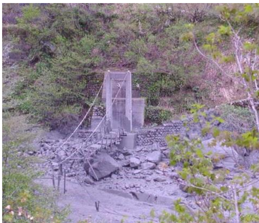
流された吊橋 (H16. 5. 17)
