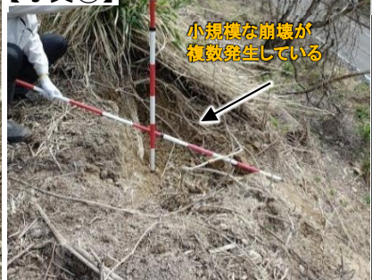
【写真③】 令和8年4月撮影(被害状況)
