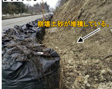
【写真②】 令和8年4月撮影(被害状況)
