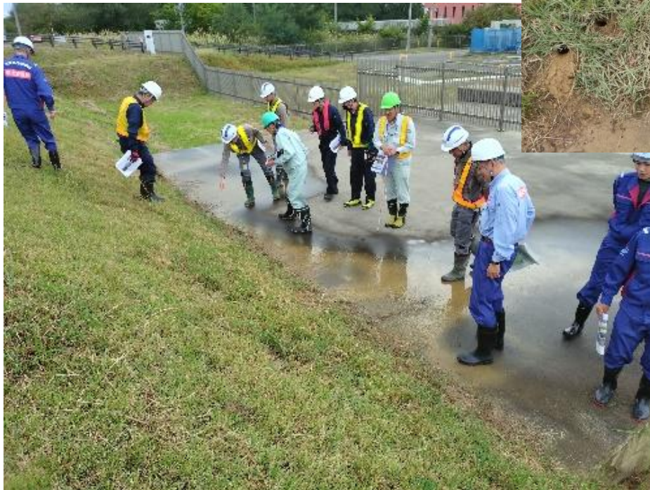
点検および現地の状況(巣穴から堤防内の土砂が流出)
