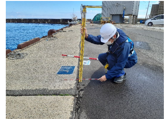
上部工背後の段差
