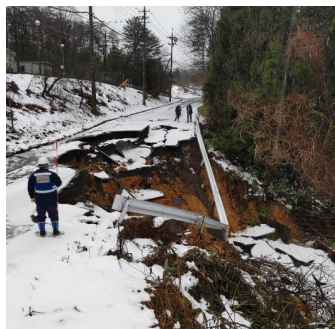
道路被害状況の調査
