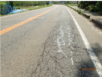
舗装のひび割れ
