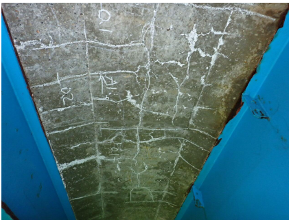
橋の裏面 (床版のひび割れ)
