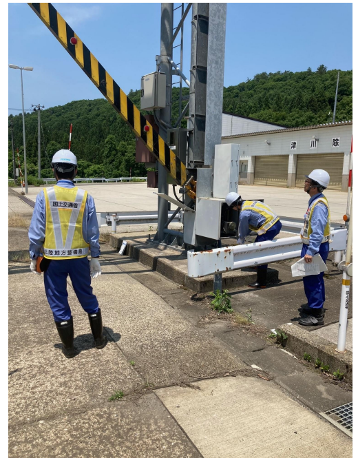
遮断機の降下作業中(津川除雪ST)
