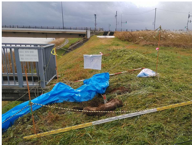
着手前（亀裂状況）
