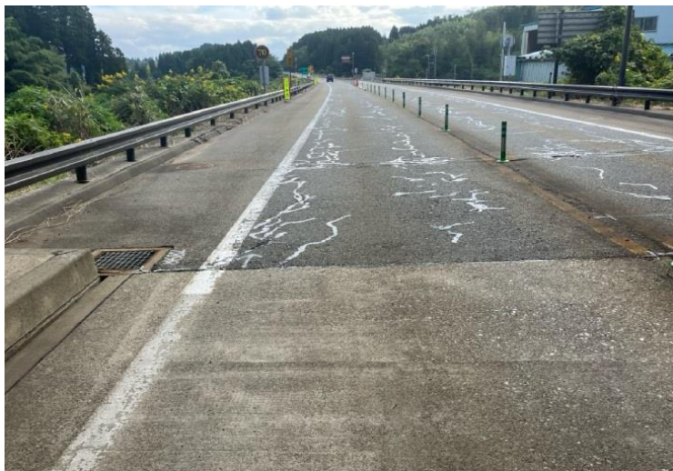
舗装の損傷状況
