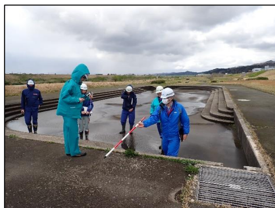
小矢部川土屋親水公園 【親水池護岸背面の空洞化】
