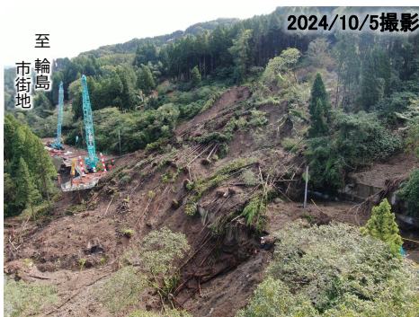
写真① 土砂流出状況
