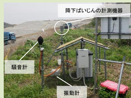
モニタリング計測機器の設置状況
