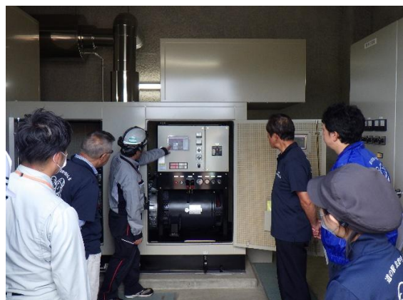
【非常電源用発電機の説明】
