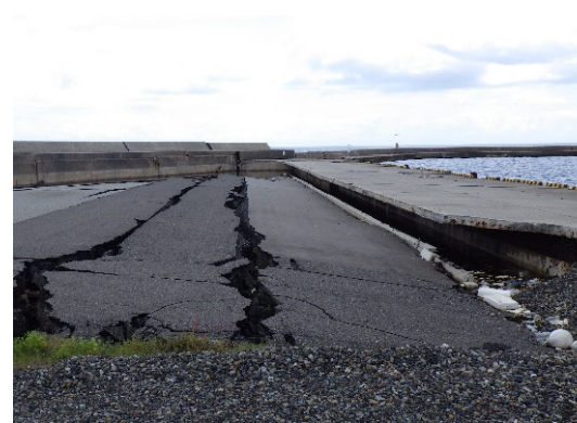
岸壁背後の陥没
