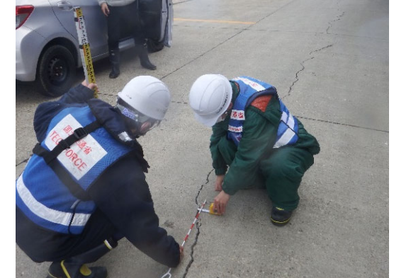
エプロンの亀裂
