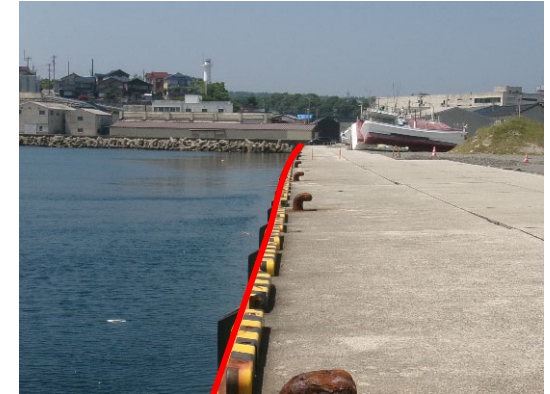
岸壁のゆがみ
