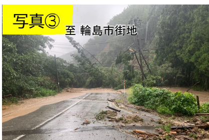
輪島市街地方面を望む (R6.9.21_10時撮影)
