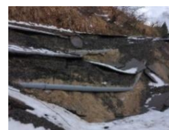
浄水場から配水池へ向かう 水道管の破損・露出（輪島市）
