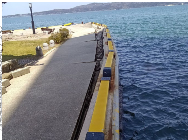
和倉港の被害状況
